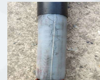
电缆受潮 放电接头 定位
