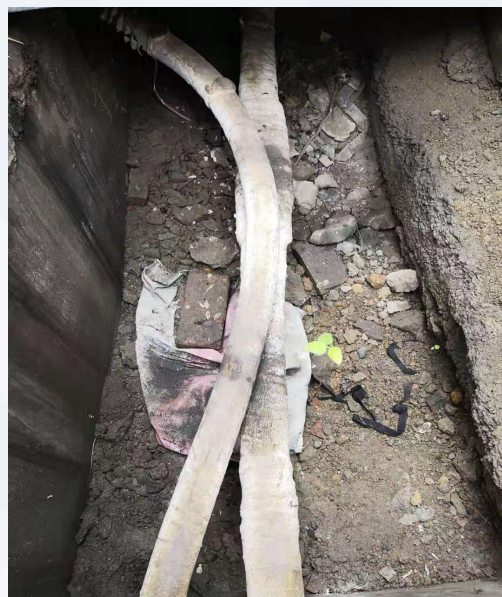
859米处 电缆通道潮湿 (接头受潮)
