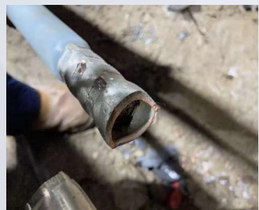
电缆接头 局放缺陷 定位
