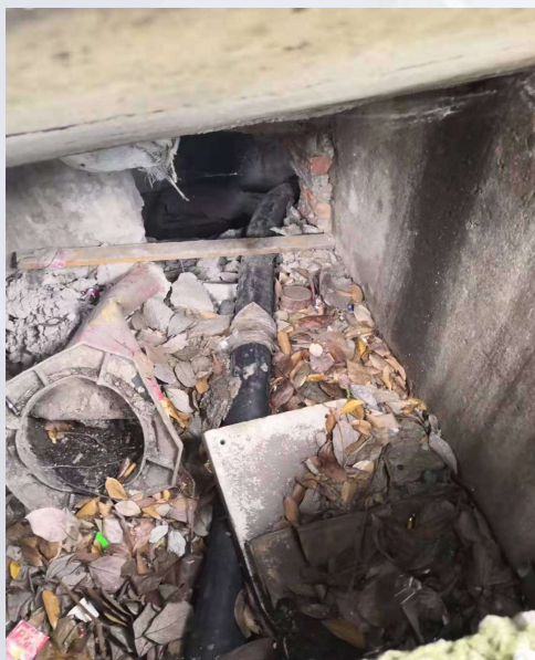
514米处 转弯半径不足 (过度弯曲)
