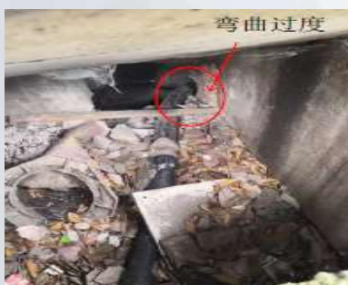
机械损伤 (弯曲过度)
