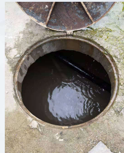
1400米处 电缆完全浸没于 水下(接头受潮)
