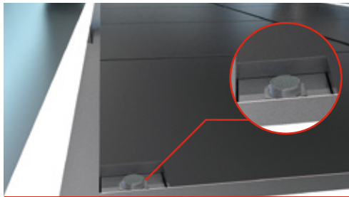
汽车换电站底盘定位检测
