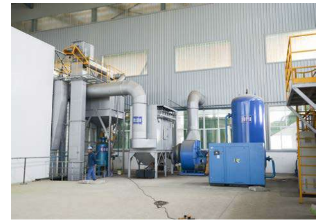
VOCs废气处理系统
