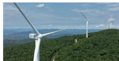
东宁2台机组雷电智能监测改造项目
