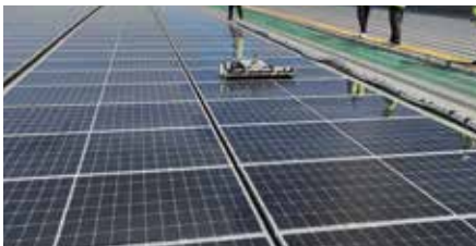
河北唐山屋顶光伏
