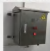
通讯供电一体箱
