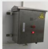
通讯供电一体箱
