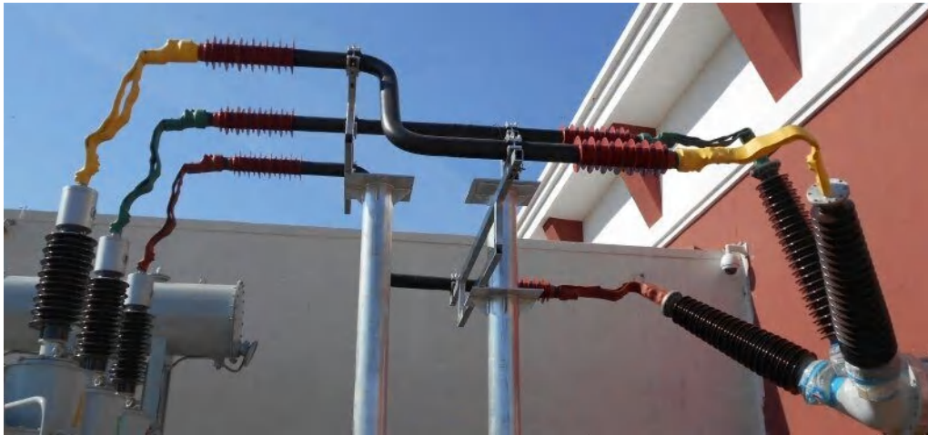
72.5kV/1600A 国家电网变电站
