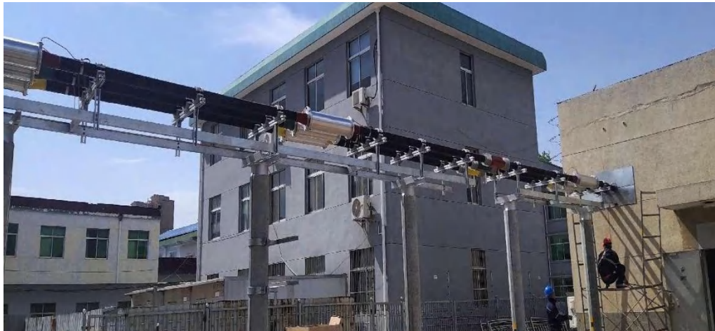
12kV/5000A 生物质发电
