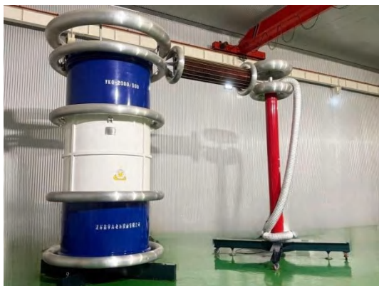
高压试验设备
