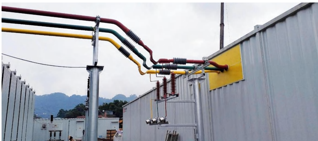
40.5kV/6300A 光伏发电
