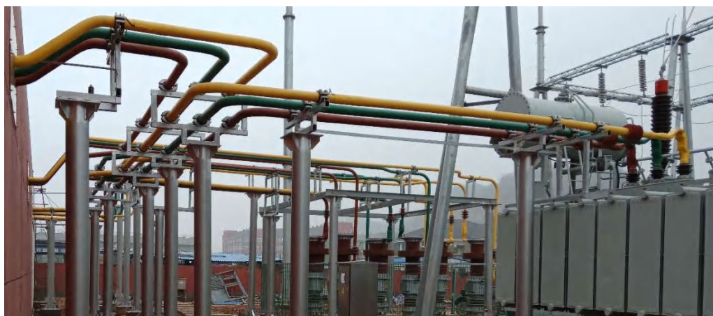
12kV/4000A 钢厂余热发电
