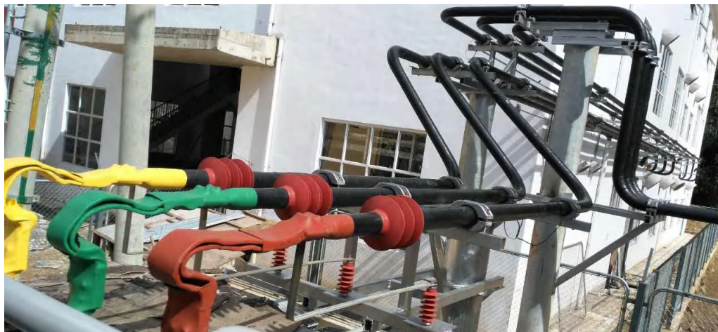
12kV/3150A 水力发电
