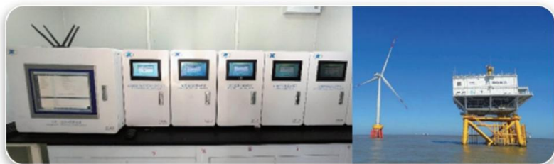
华能大丰扩建100MW海上风电生态修复项目在线监测系统建设
