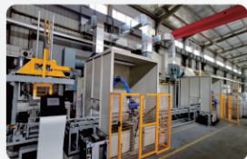
达克罗生产线 Dacromet Production Line
