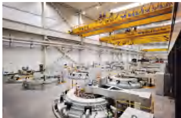
热处理车间 Heat Treatment Workshop
