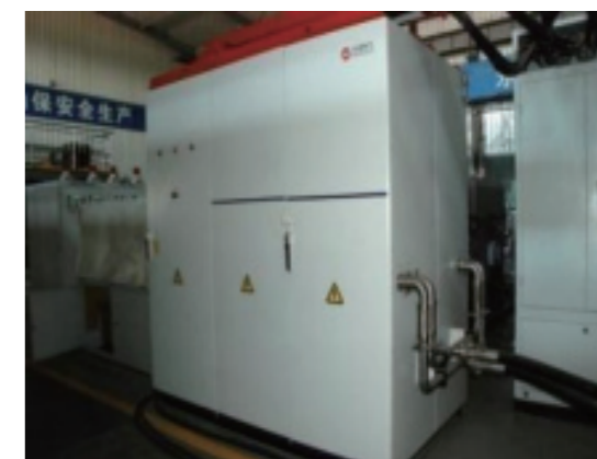
2.5MW全功率变流柜
